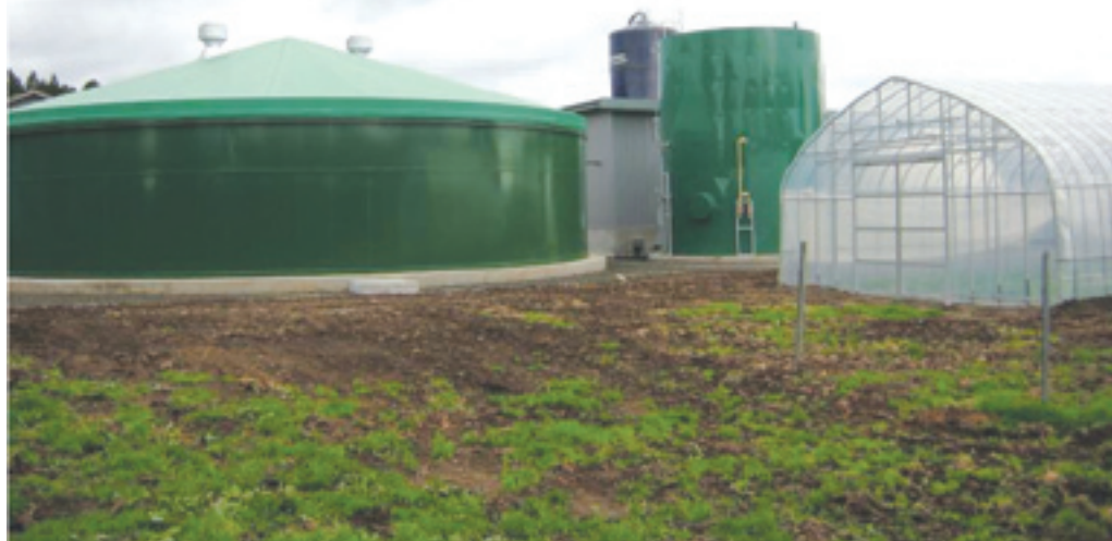
Impianto per la produzione di biogas. In primo piano il serbatoio ove avviene la digestione anaerobica.
